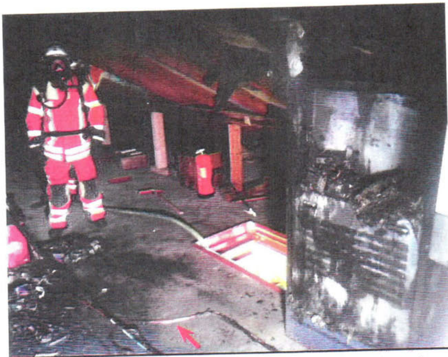
Blick auf den Dachboden. Rechts ist der ausgebrannte Photovoltaik-Stromspeicher zu erkennen, dahinter die Zugangstreppe (»Dachbodenleiter«). Im Vordergrund liegt die durch das Feuer beschädigte Hauptanschlussleitung der Hausinstallation (Pfeil).
