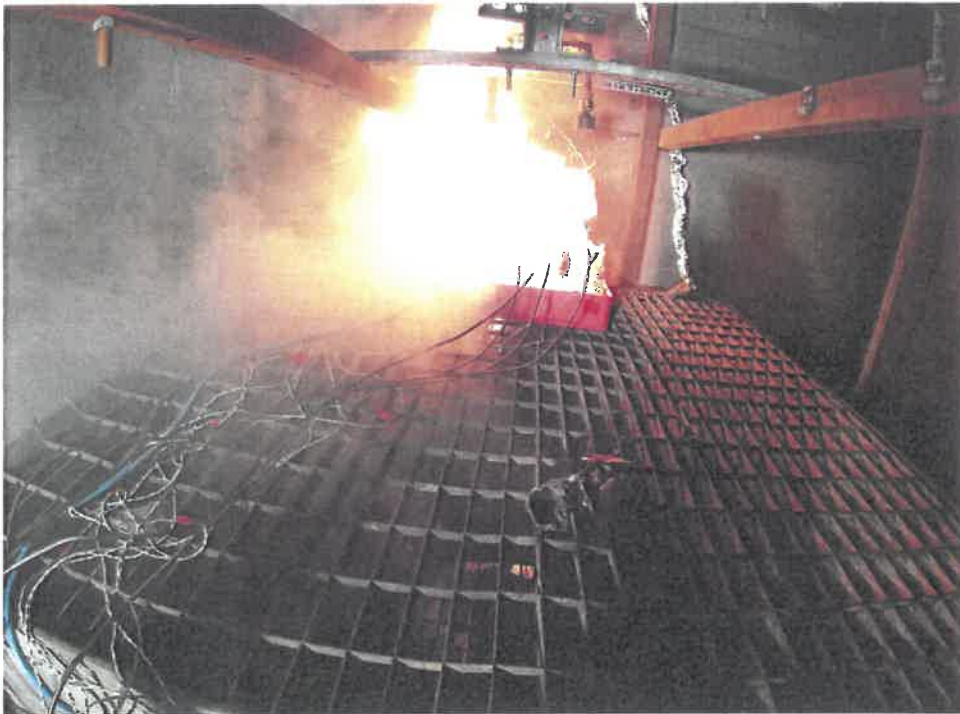
Abb. 2: Blick in die Versuchskammer nach thermischem Zünden des Batteriemoduls mittels der beiden integrierten Glühkerzen. Oberhalb des Moduls sind die beiden Löschdüsen zu erkennen.
